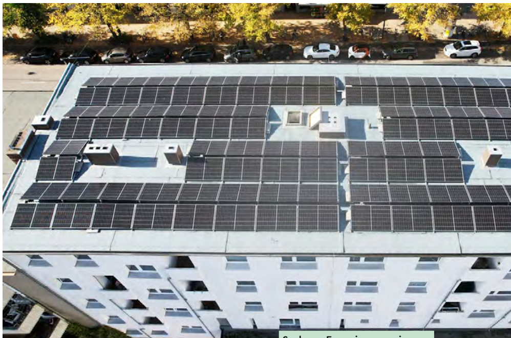
Saubere Energie vom eigenen Dach: Die Photovoltaikanlage in der Holtenauer Straße ist ein weiterer Schritt zu einem nachhaltigeren Geschäftsbetrieb.
